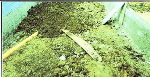
Foto 8: Red de drenaje dentro de cocina y un aula.
